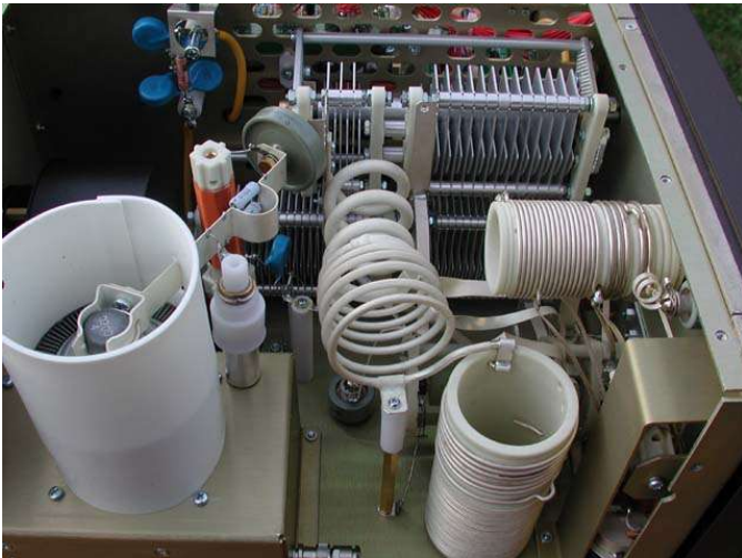
HF sidan i närbild. Längst till vänster vilar röret i sitt "kyltorn". Spolar och kraftiga vridkondingar ligger prydligt uppgradade.
