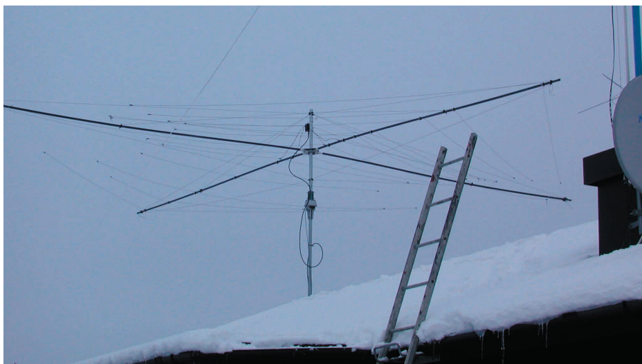
Radioamatörer gillar stora fina antenner. Att kliva omkring på taken med dom är inte alltid så roligt särskilt när det ligger snö. Men när dom väl sitter där är man glad och inte minst, man når långt.
